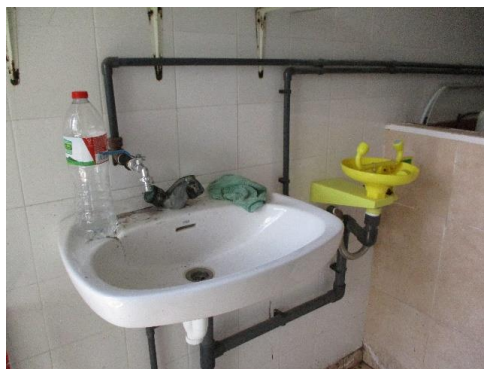
Il·lustració 28. ETAP Dipòsit Nou: sala d'emmagatzematge de reactius
